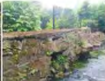
Protection de berge détériorée
