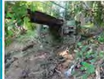
Piliers de la passerelle détériorés
